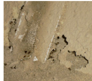
Dégâts causés par les ténébrions
