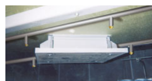
Localisation des buses de brumisation
